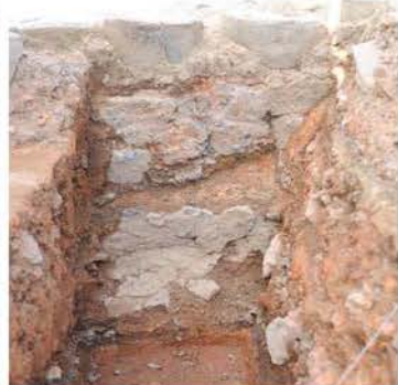
사진 15. 벽체 수축 상태
